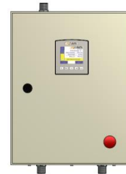
Figura 2 – Painel de Comando
